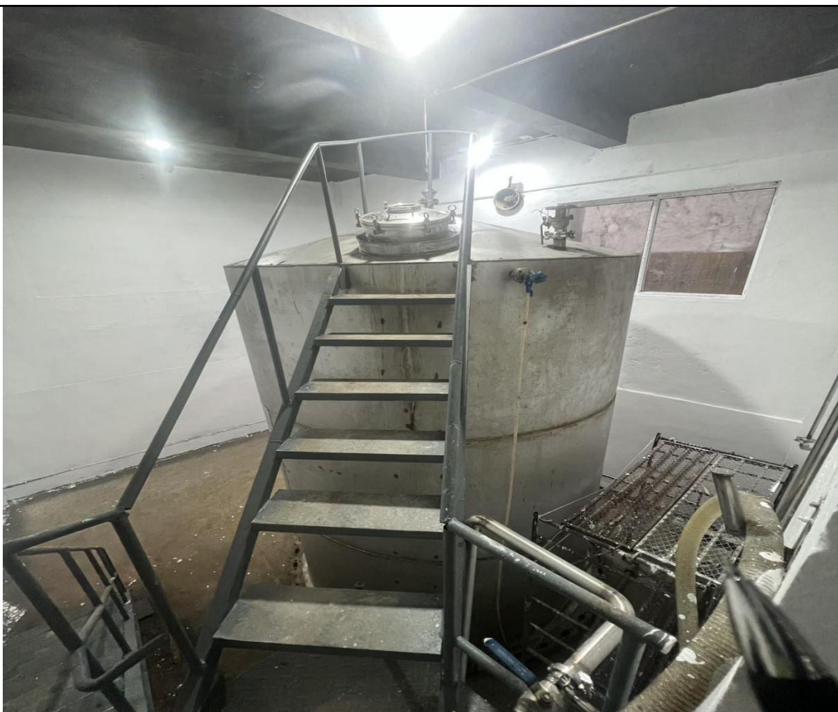
地埋乙醇储罐
