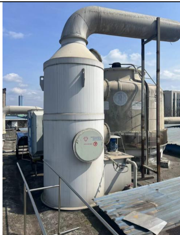
水喷淋+二级活性炭吸附排气筒（DA002）
