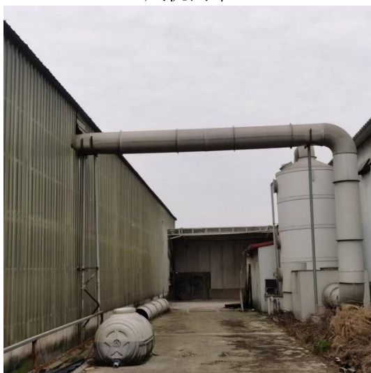
外置除尘系统
