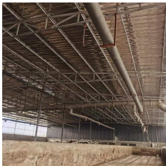
舍内吸气管道
